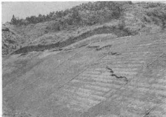
写真-4 締固め不十分によるのり面のすべり状況
