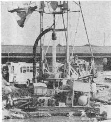
写真-2 ポンプ式リバースサーキュレーション工法による掘削例、掘削径1.5 m、深度 102 m (土木研究所千葉支所内のテスト風景)
