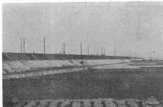
写真1 盛土のり面防護工（腰土留め、格子わくおよびコンクリートブロック張り）
