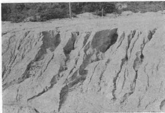
写真-1 降雨により洗掘された砂質土ののり面
