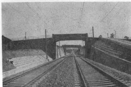
写真2 切取のり面防護工（土留め擁壁およびコンクリートブロック張り）
