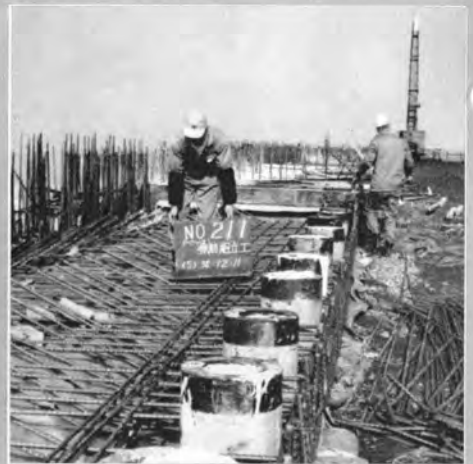
↑ 鍋田堤における擁壁基礎コンクリート ぐい打込みおよび底板鉄筋組立て
