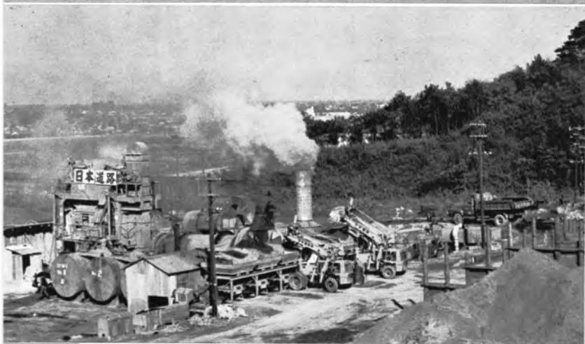
← アスファルトプラント (60 t/hr)
