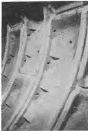
写真-4 コンクリートセグメント は巻立て後、目地をモルタル で塗りつぶし、裏込め注 入を終われば直ちに組立ボ ルトが取りはずされてい る。
