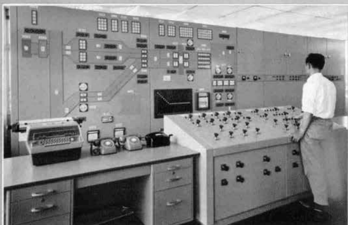
↑秋ヶ瀬管理所自動制御装置の操作盤とグラフィックパネル 水位9箇所(荒川、水路、沈砂池等)、流量2箇所 のデータにより12の水門を自動制御し、また ピンボードにより新河岸川への浄化放流量を プログラム制御する
