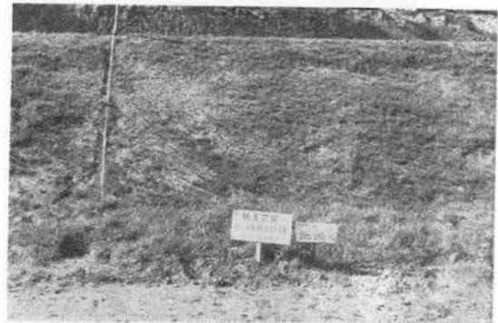
写真-12 泉北地区機械化施工計画 のり面保護工のテストフィールドの一部
