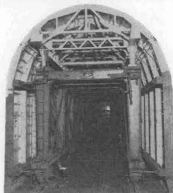
写真は国鉄新清水隊道工事用 スチールフォーム 鉄建建設株式会社 大成建設株式会社 前田建設工業株式会社 納入
