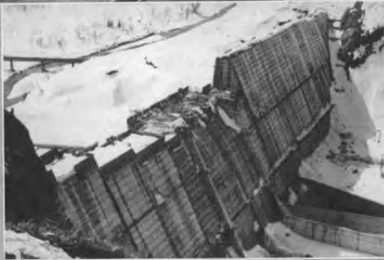
↑ 金山ダム左岸 ダム打設状況 (昭和41年3月) コンクリート量 205,162m 3
