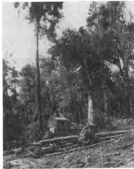
写真-1 D120 ツリドーザの倒木
