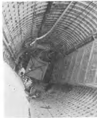
写真-11 スキップウエイ防護設備(下部)
