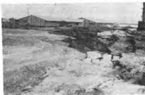
写真-9 ヘドロ上まき出し土の陥没流動状況(堺)
