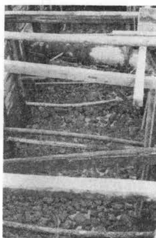
写真-2 ジョイスト工法の悪い例
