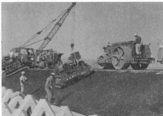
写真-1 1:2 こう配の堤防のり面アスファルトライニングの機械仕上げ状況
