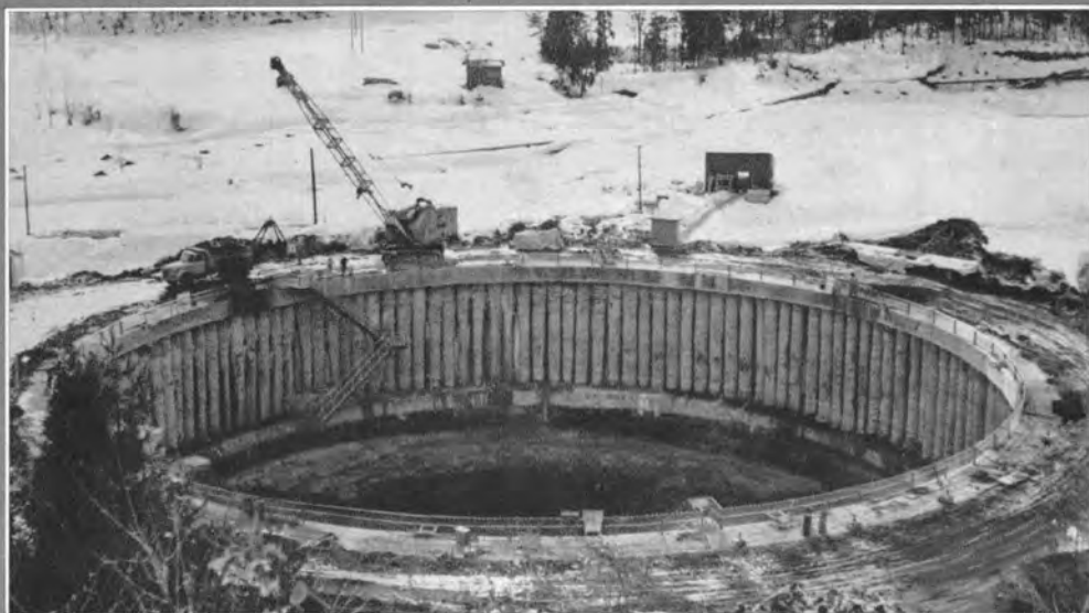
プレウォール工法による採鉱工事全景（秋田県・花岡・大石沢鉱床開発現場）
