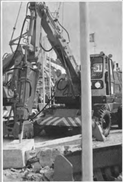
コンクリート破砕機
