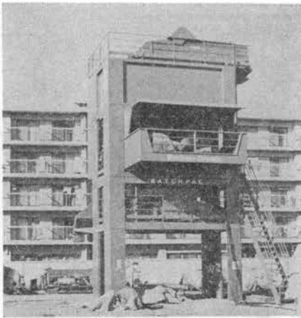
写真-16 BE-42 150t アスファルトプラント
