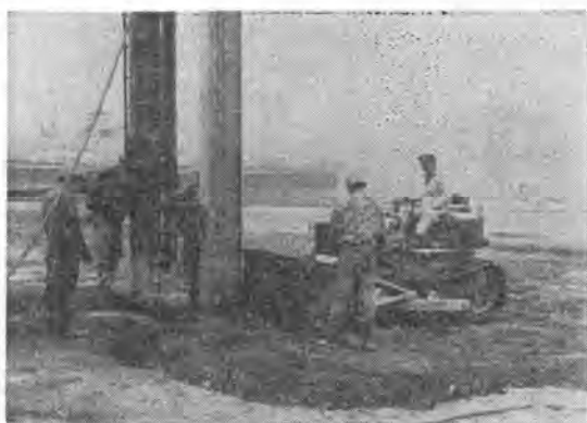
写真-8 締固め施工中は周辺地盤が沈下して重機の足もとが危険であるので、ブルドーザが1台ついて表土を削って補充する。
