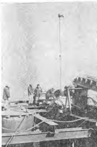
写真-5 コンクリート打設作業のうちのトレミー管建込み
