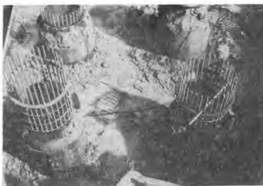
写真-6 場所打ちしたくいの頭部 レータンスの状態がわかる
