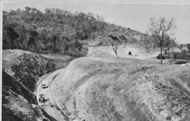
249k500m 付近(両カット部)よりトンネル方向を望む路盤転圧仕上げ作業中(小松振動ローラ4t)
