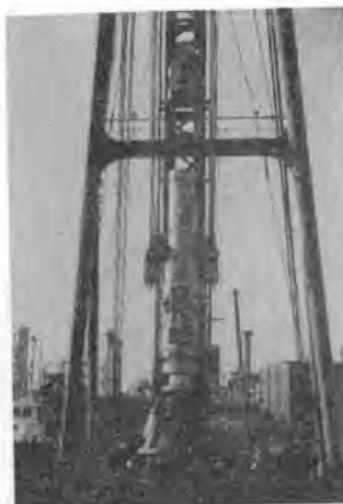
写真-1 東京港灯台基礎試験くい打ちのためにくい打船に装備された MB-70
