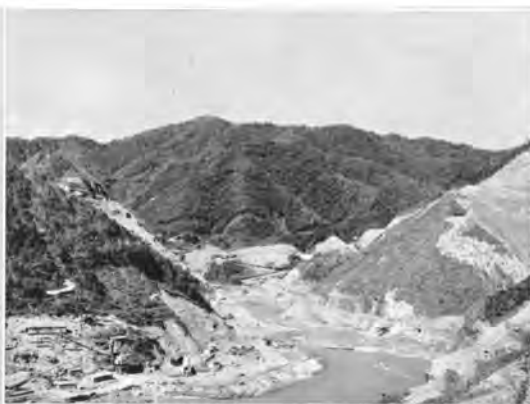
上流側よりダムサイトを望む(40.9) 工事用道路、仮排水路、ダムサイト左右両岸の掘削、および右岸洪水吐前庭部の掘削
