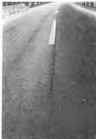
写真-2 コールドジョイント
