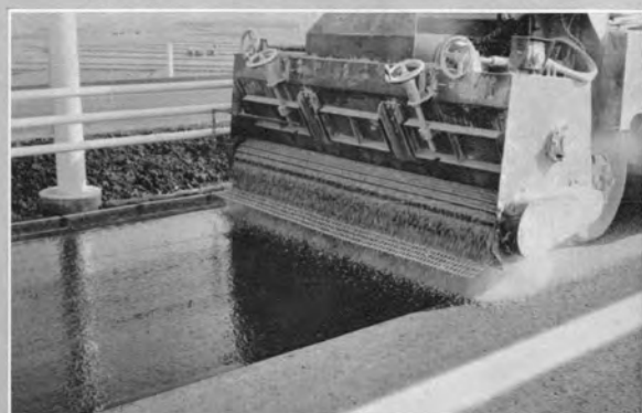
↑路肩のシールコートを施工するため、MC-5を散布後2~5mmの骨材をスプレッドマスター(TS2401(株)新潟鉄工所製)で1m 2 当たり0.5l散布し、タイヤローラで転圧した
