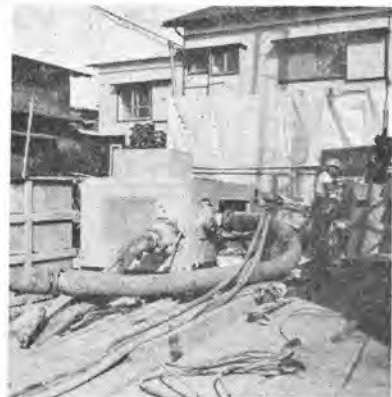
写真-2 パワーユニット
