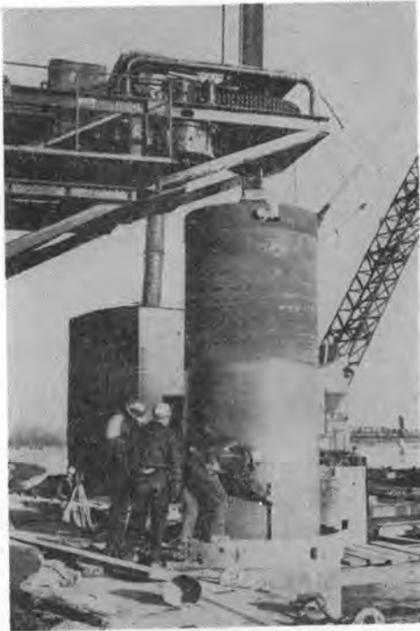
写真-2 保護ケーシングの中にケーソンを下しているところ 検測している作業員が乗っているのがすでに打込まれた保護ケーシング
