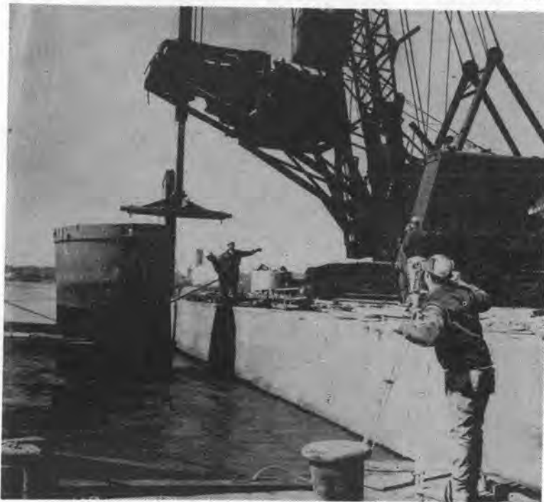
写真-1 保護ケーシング打込み前の位置決め 掘削装置の駆動部分、ケリーバー、ケリーヨークなどがわかる。
