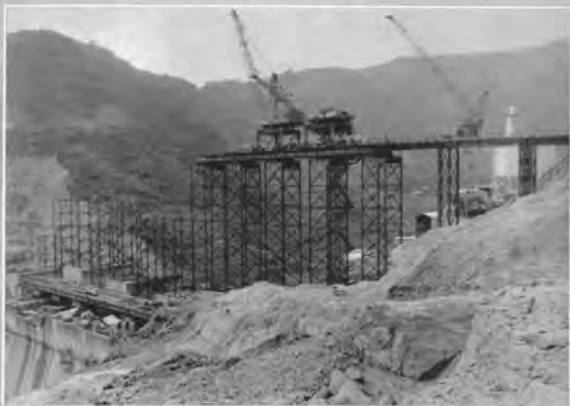
↑ジブクレーンおよびトレススルガーダの移設（41年7月、E L277.5、コンクリート約43万 m^3 ）
