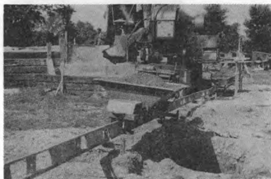
写真-18 モノレールバケット
