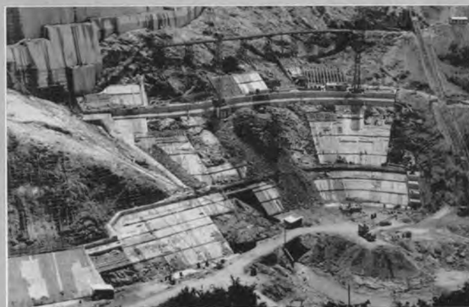
↑遮水壁工事全景（吹付けおよびコンクリートフェーシング 工事，最下部はカットオフ，右側は10t インクライン）
