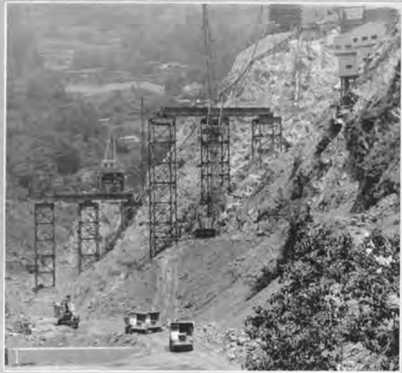
↑トレススルガーダおよびジブクレーンの組立て始まる (40年6月、右上コンクリートプラント56S×3形2基)
