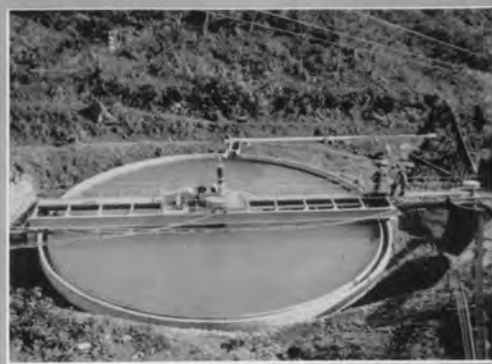
↑左岸に設けた濁水処理プラントの シックナー（直径18m）
