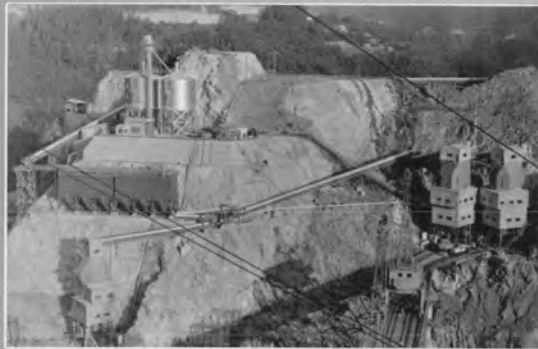
↑完成したコンクリート打設設備(40年8月, セメントサイロ他56S×3形コンクリートプラント3基, サイロ下方骨材調整ビン)
