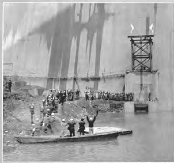
↑堤体内仮排水路の閉塞用ゲート (42年11月24日、一次湛水開始)
