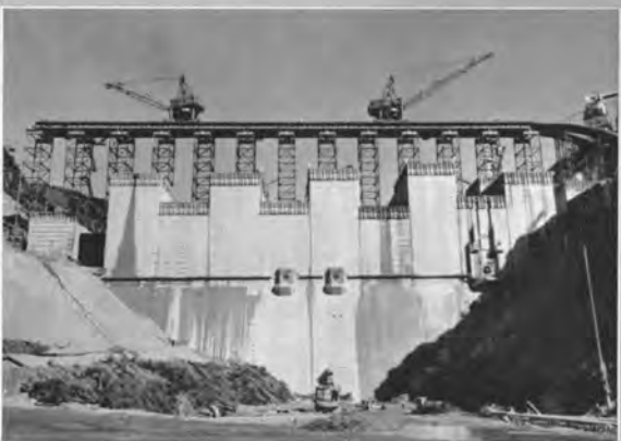
↑コンクリートの打設量は約半分の60万 m^3 （41年11月、高さ約80mに達する）
