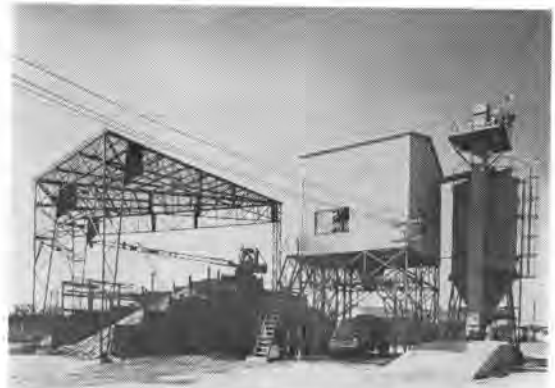
写真-1 コンクリートプラント(工場内設置)
