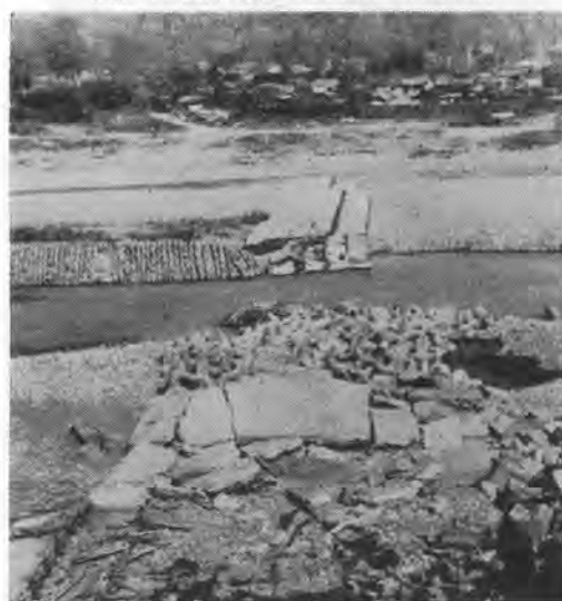
写真-2 真中で折れた小沢頭首工
