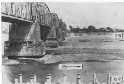
写真-1 橋脚の根固めが浮上がった相模橋
