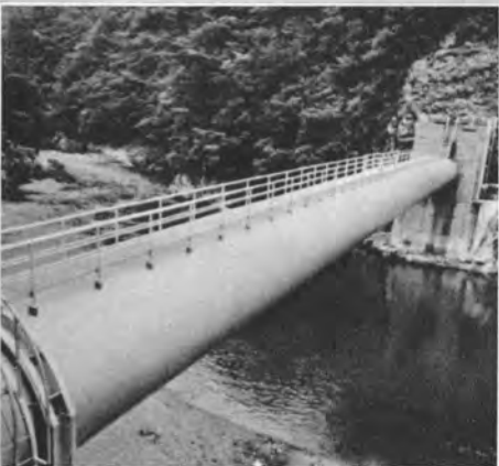
↑ 佐久間導水路大千瀬川サイホン
