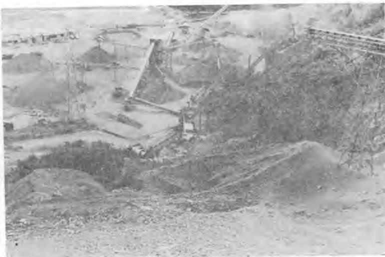
写真—1 都留工場骨材生産プラント全景
