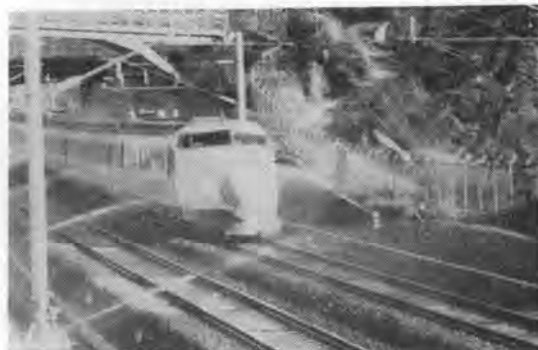
写真-6 パイプラインとスプリンクラーによる新幹線のぬれ雪化装置(関ヶ原付近)
