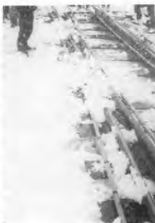
写真-5 散水ポンプによるポイント融雪装置
