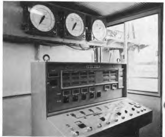
自動計量操作盤
