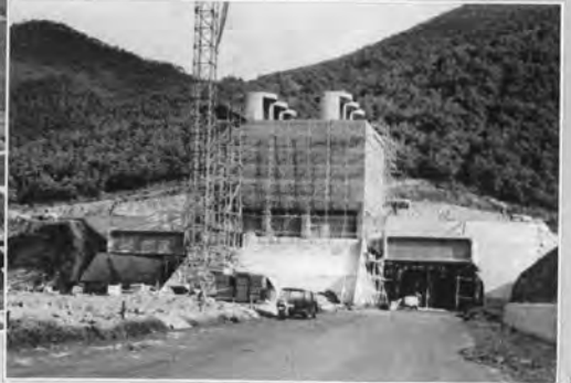
↑ 宇利トンネル西口換気塔
