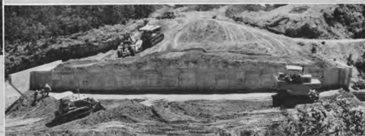
↑ タイヤローラによる横断構造物（カルバートボックス）の裏込め転圧（浜松工区）
