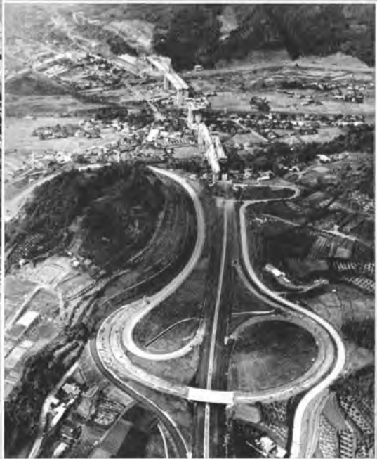
→ 完成間近い大井松田インターチェンジ 前方施工中の川音川橋りょう（デビターグ工法）
