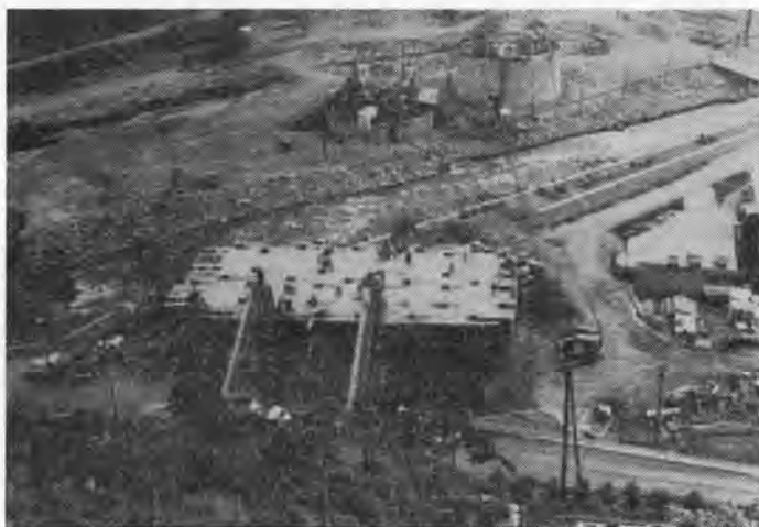
写真-1 P_1 ケーソン躯体コンクリート打設状況(足場に単管足場パイプ使用)
