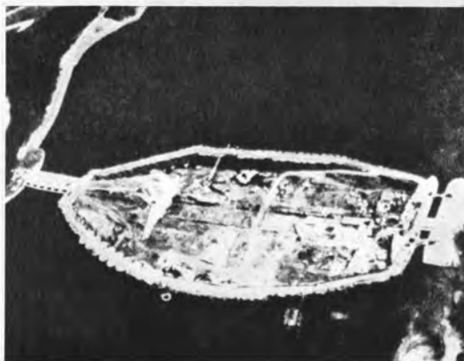
↓ 1968年1月に完成したフランスのランス潮力発電所の建設現場
