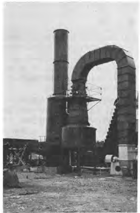
写真-1 150 t/hr アスファルトプラントに装着した湿式集じん機
