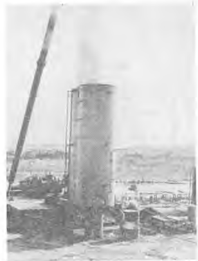
写真-2 4m 防音カバー
