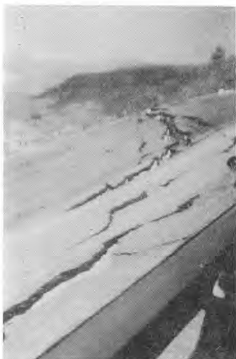
写真-7 路面の亀裂
