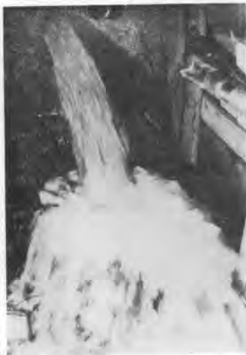
写真-1 浦本トンネル長孔ボーリングの湧水
