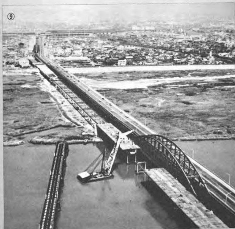
⑨ 御堂筋線 新淀川架橋部分左岸より新大阪駅方面（工事中は北行車線。高速鉄道1号線，南行車線は完成）
