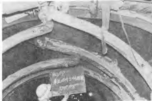
↑ 写真-5 頸城1工区1,580m付近 吹付けコンクリートは落支保工変状
