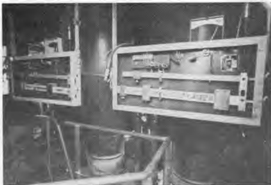
写真-3 計量設備
