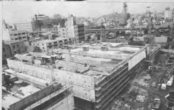
1号館の地上躯体工事 屋上では高速道路高架 街路のけた架設が進ん でいる。(44年5月)
