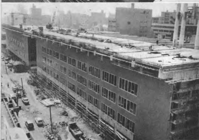
同上 床版となるPCけたが並べられ、 ビル壁のモザイクタイルも仕上がった。 （44年5月）
