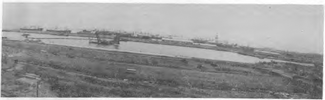
写真-4 横浜港本牧ふ頭コンテナバースの舗装工事(第1バースコンテナヤード)
