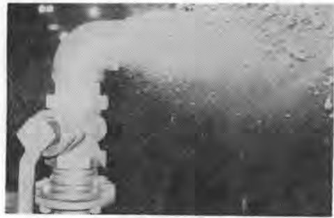
写真-2 中詰コンクリート噴出状況 (作業室スラブからセットされたブローパイプ先端)
