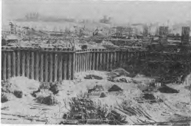
写真-1 基礎施工状況(シートパイルは地下室外壁の軀体として利用)
