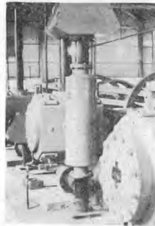
写真-4 75 kW 単シリンダ形 定置式空気圧縮機の消音器
