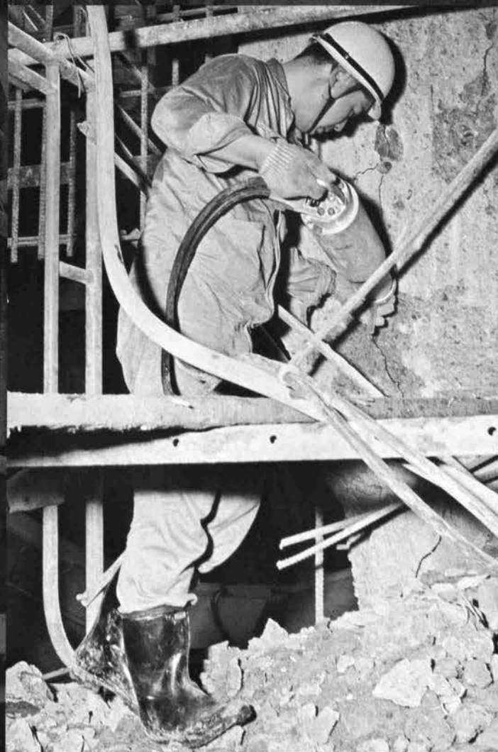
地下鉄工事現場のコンクリート破碎作業に活躍する〈ダルダ〉ロック・スプリッター
