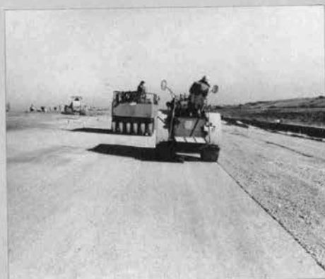
▲ 越流堤舗装基盤工におけるクラッシュラン30-0mmのタイヤローラ、マカダムローラによる転圧作業状況 (昭和44年11月)
