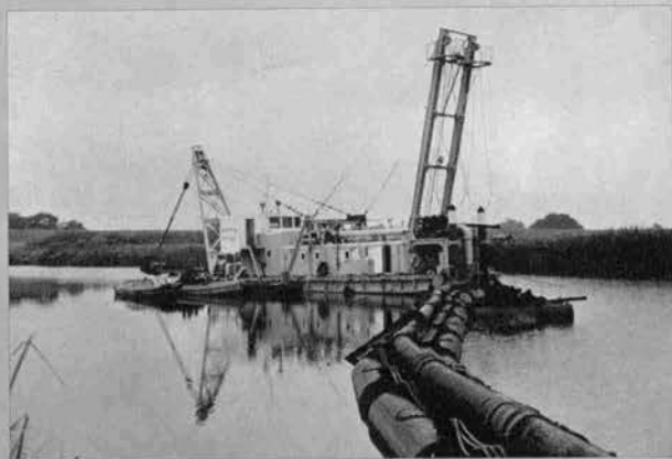
◀ 圍繞堤の築堤土を浚渫採取送泥する電動500HPのポンプ浚渫船(官船) (昭和43年1月)
