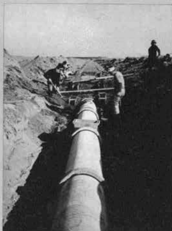
▲ 越流堤の川側、池側のり途中に堤体内に浸透した水を堤外に排水するための \phi 470\text{mm} 、 l=2.45\text{m} の有孔鉄筋コンクリートヒューム管とフィルタ材の巻込み状況 (昭和43年11月)
