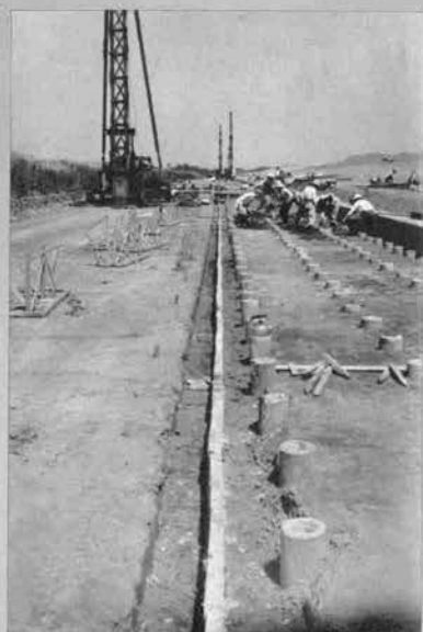
▲ 下流越流堤池側のり尻部に横断面長4.6m、縦断長1,400mの副ダムの基礎PCコンクリートぐいおよび加圧コンクリート矢板の打込み状況 (昭和44年5月)
