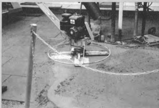
▲表面仕上げ機
