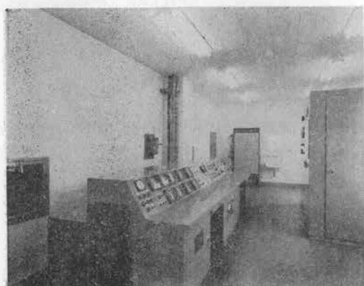
写真-2 観測室の監視制御装置
