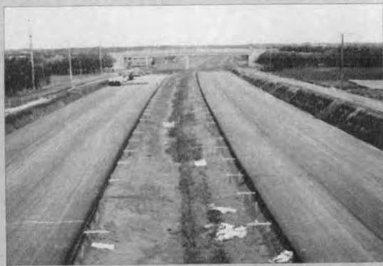
◀ 東京側より見た四街道町鹿放地内で、アスファルトベースの施工中である。
