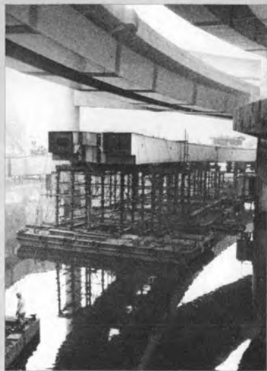
◀江戸橋インターチェンジの一部はけた下空間が制約されるためポンツーンを用いて架設した。
