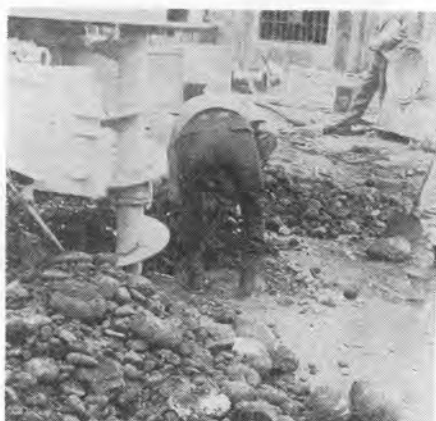
写真-3 D-60 H 形アースオーガによる札幌地下鉄工事における玉石層の掘削
