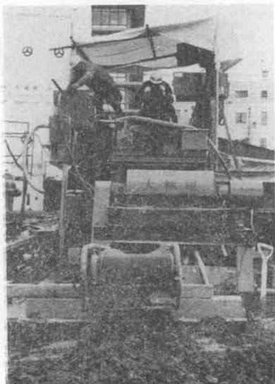
写真-14 遠心分離式泥水処理装置
