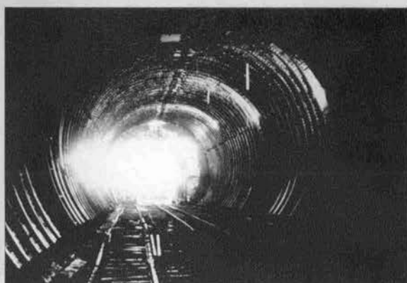
▲高塚山トンネルの全断面をビッグジョーンで掘削した後、リップ&ラッキング方式により建込まれた支保工全景
