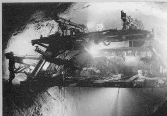
▼西庄トンネルの上部半断面掘削に使用された長孔さく孔用の4台のZAXと3台のヘビードリフタ装備のジャンボ
