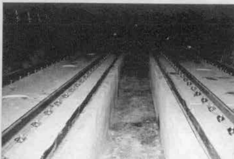
▲保守作業のメンテナンスフリーとして 開発されたスラブ軌道の敷設状況
