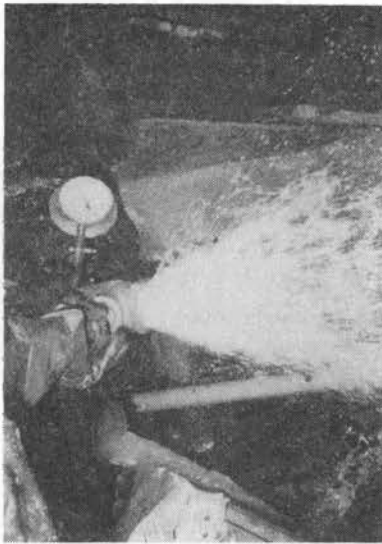
写真—3 中津川方パイロットトンネル先導導坑での被圧水（隣接孔へ圧力水がにげるためゲージは 8 kg/cm 2 を示す（推定 20~30 kg/cm 2 ）。白ヶ久保第 11, 第 12 断層被圧水帯）
