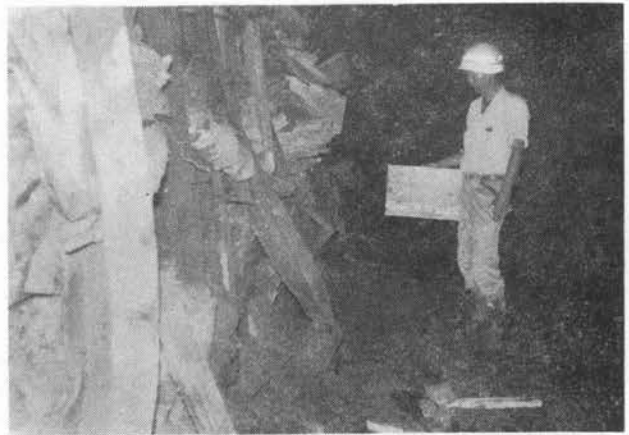
写真-1 導坑支保工の座屈状況と増わく支保工の変形状況
