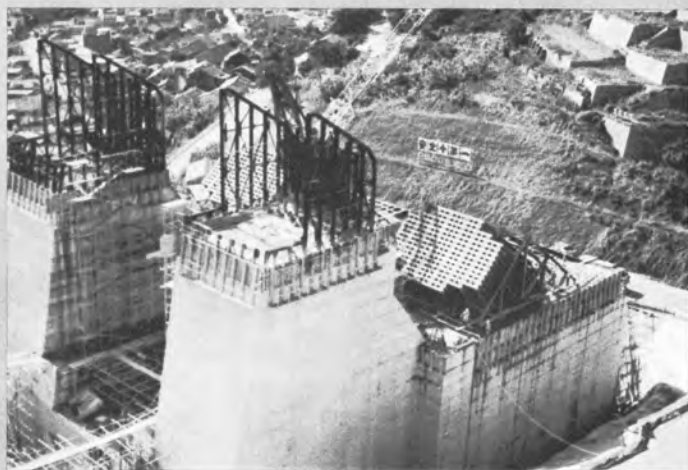
▲下関側橋台の中に埋め込まれるサドルベントの鉄骨およびケーブルアンカーフレームの設置（アンカーフレームは約 1,500 t の重量があり、四角の孔が前面に 154 あり、ここにケーブル端が固定される）
