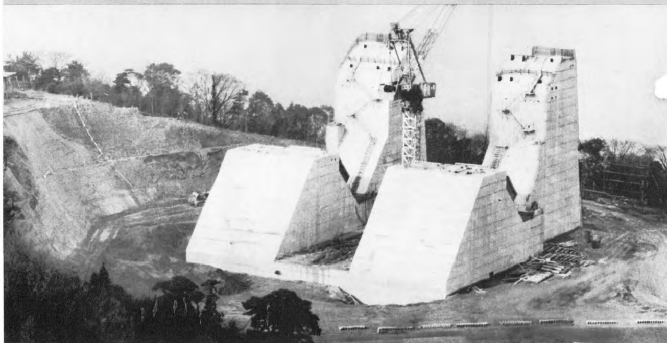
▼完成した門司側橋台（使用されたコンクリート量は約6万 m^3 である）
