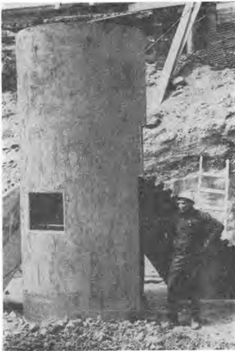
写真-2 鐘状潜函はピボットカッター棒のついたリーマでせん孔される。最大直径 3.6 m の立坑は約 6 m の地下で直径 9.9 m の鐘状部に広げられる。
