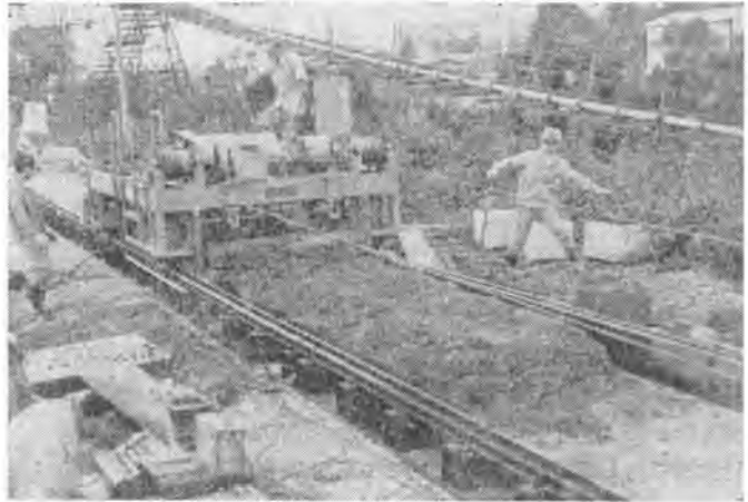
コンクリート舗設試験機によるスリップフォーム式舗設の実験
