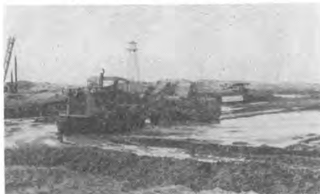
写真-4 被けん引式スクレーパによる掘削 (高潮による冠水状態)
