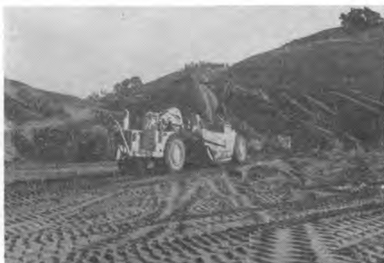
写真-3 モータスクレーバの稼働状況
