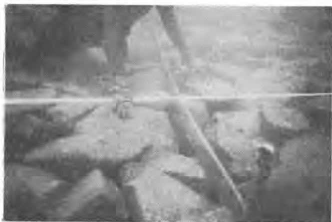
写真-3 潜水夫により施工されたケーソン設置用基礎ならし
