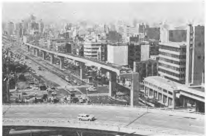
写真—1 阿波座付近で進む大阪東大阪線上下部工事（手前は西横堀の既設部分）
