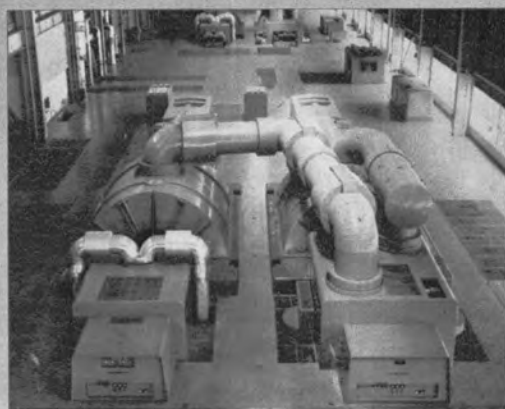
▼蒸気タービン(単機出力60万kW)
