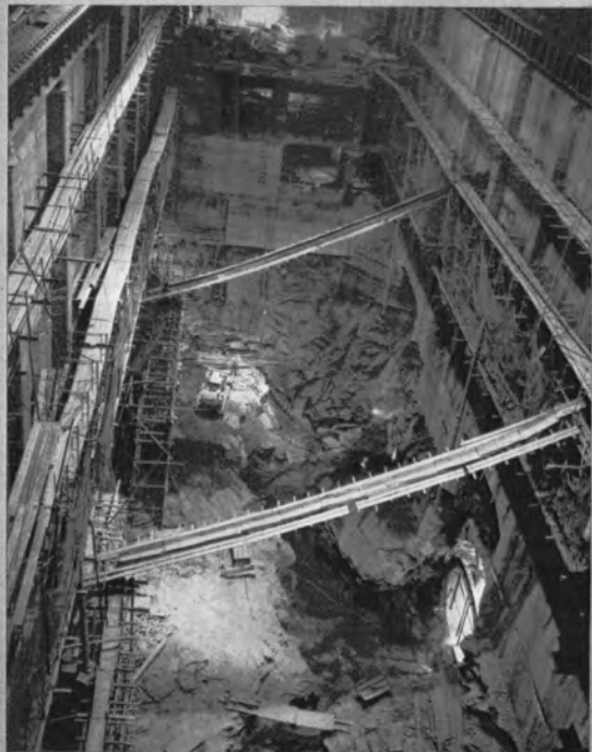
▲地下発電所主機室
