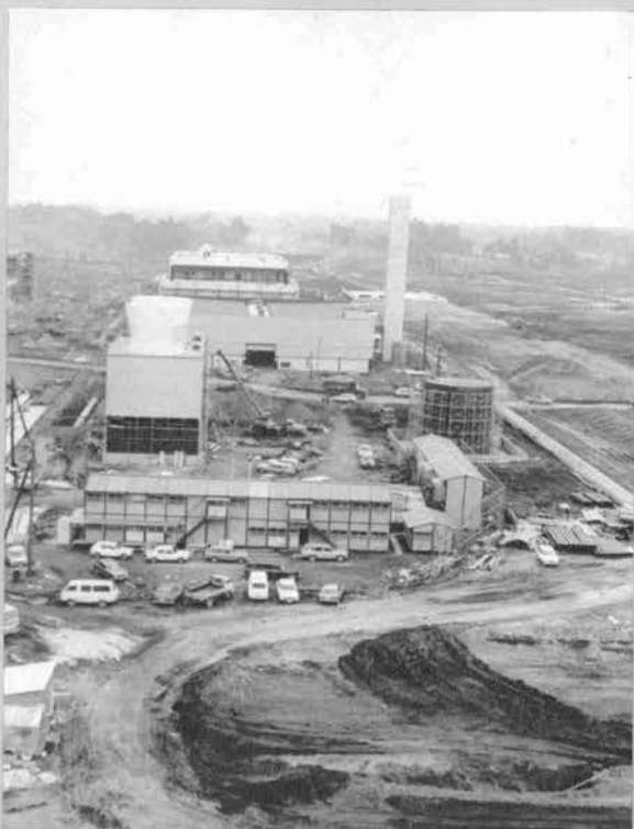
▲中央冷暖房設備
