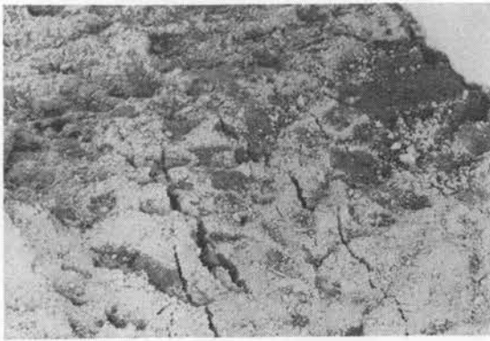
写真-4 ウェル周辺地盤の影響
