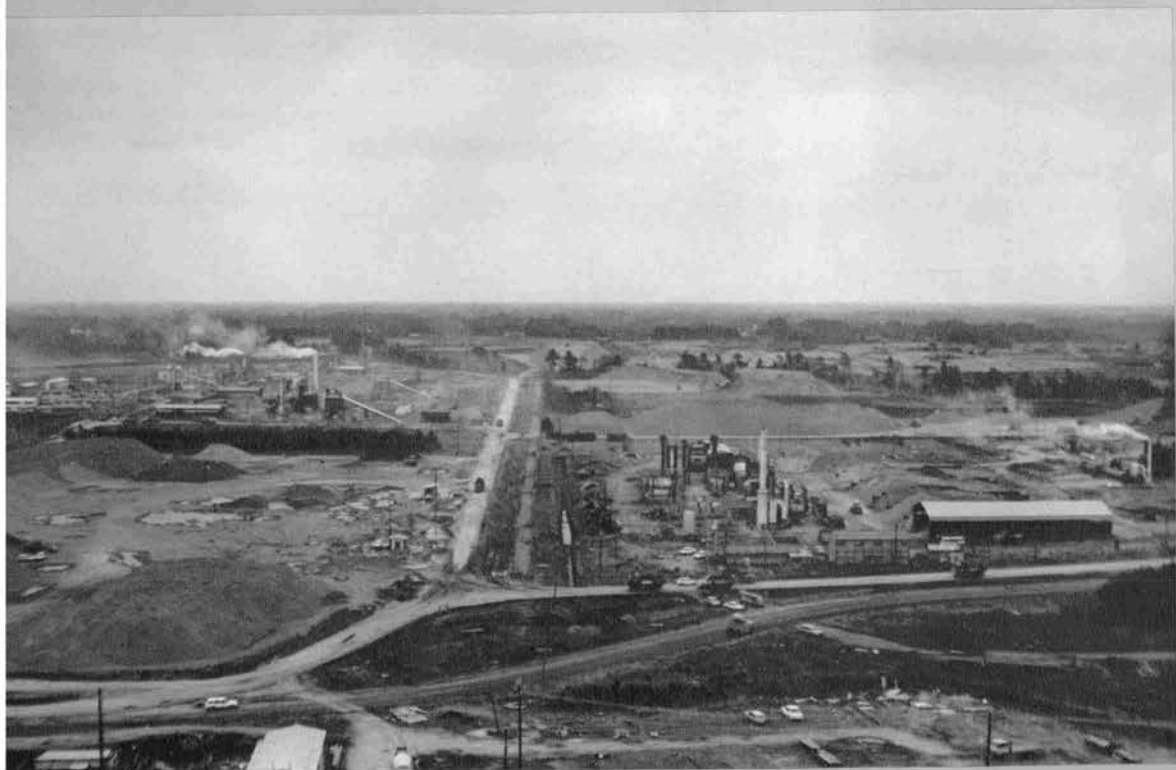
▲舗装用プラントおよび骨材置場
