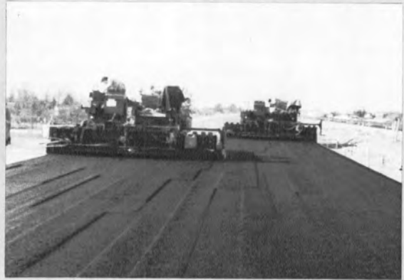
▼アスファルト安定処理ベースコースおよびホットジョイントの施工
