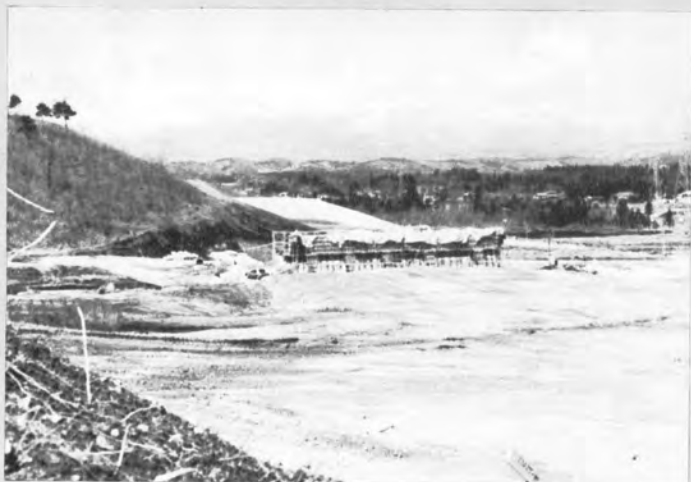
◀白河インター付近で、後方に那須連峰が望める。(白河から福島市にかけては凝灰岩やその風化物が代表的な土質で、のり面对策には苦慮している)
