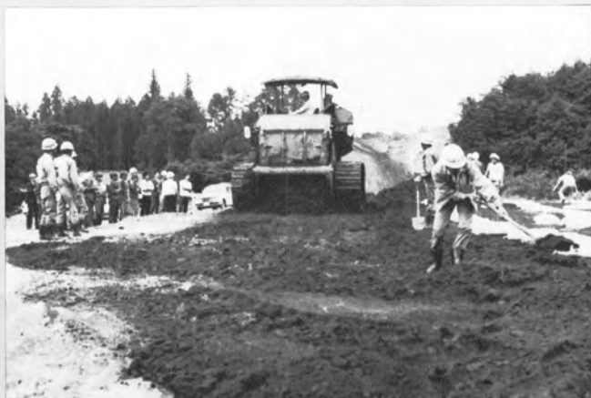
▲蔵王地点では蔵王ロームといわれる火山灰質土があり、トラフィカビリティの不足をきたしている。
