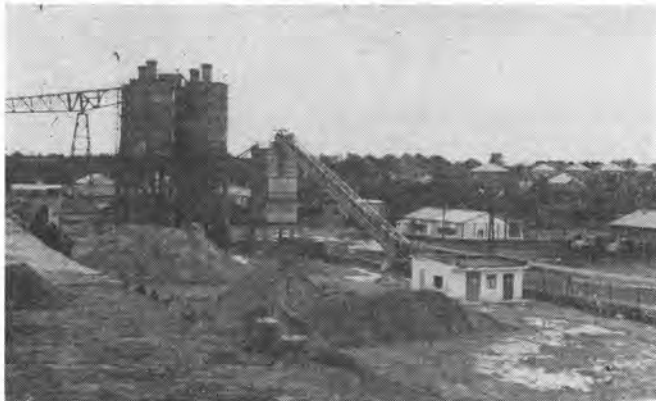
↑ 写真-3 セントラル コンクリートミキ シングプラント
