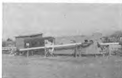
写真-1 中継ポンプ (右はブースタポンプ、左は制御装置)
