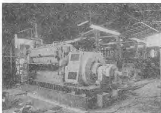
写真-8 1,600 kW ディーゼル発電機
