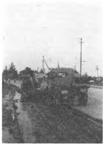
写真-15 縁石汚泥処理装置
