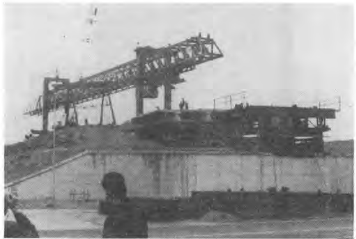
写真-1 ガントリークレーン(つり上げ能力約50t)
