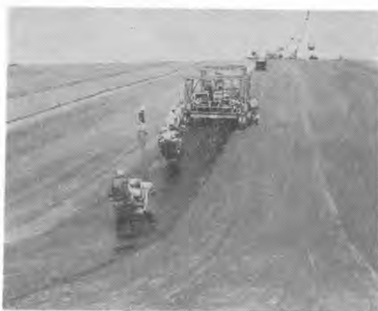
写真-20 アスファルトフェーシング機械設備
