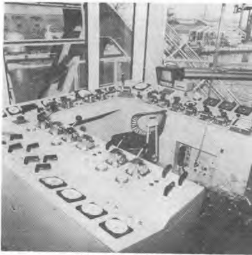
写真-2 運転操作盤
