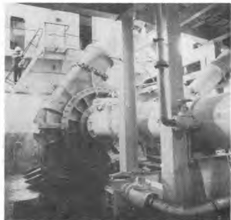
写真-3 浚漕ポンプ室
