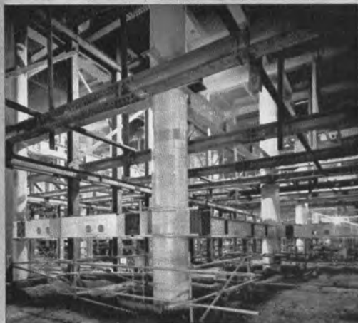
▼地下2階までの掘削が完了し、 鉄骨組立が進められている
