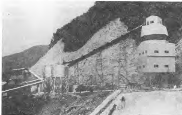
写真-3 ダムサイト左岸のコンクリート混練関係設備
