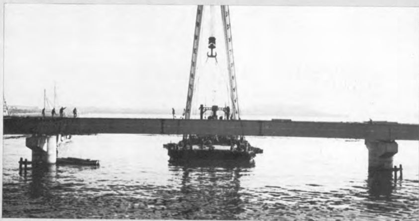
▲180tブリフローティングクレーン による連続げたの架設
