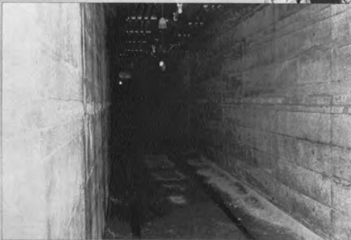
◀共同溝内電気設備
