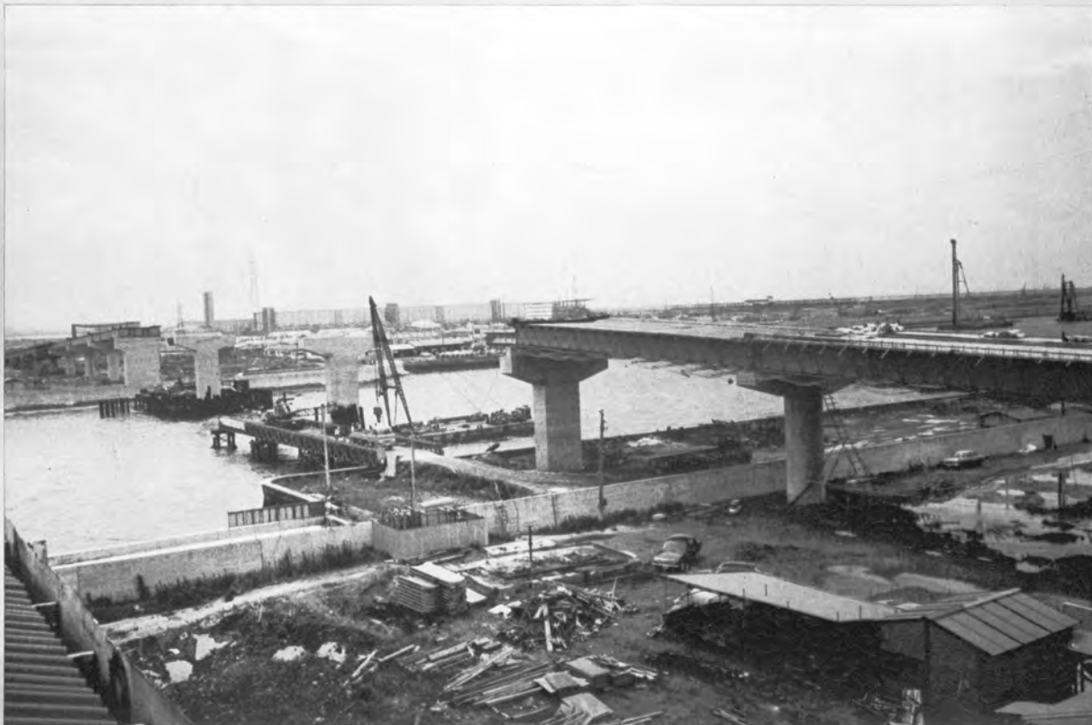
▼完成間近の海老川橋（海側2車線分） —東京側より千葉側を望む—
