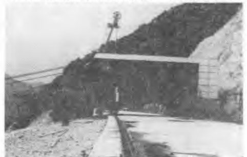
写真-4 ケーブルクレーン機械塔
