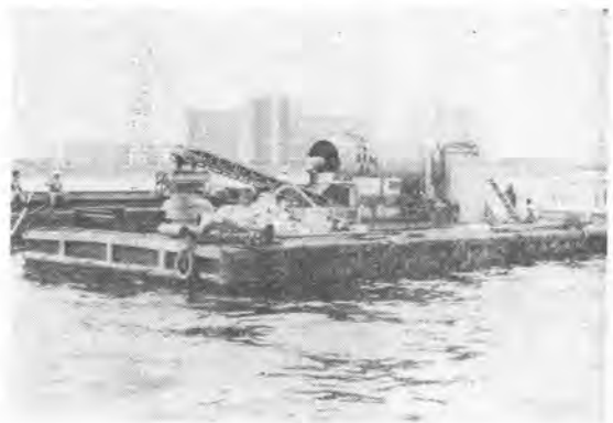
写真-5 泥水浄化装置
