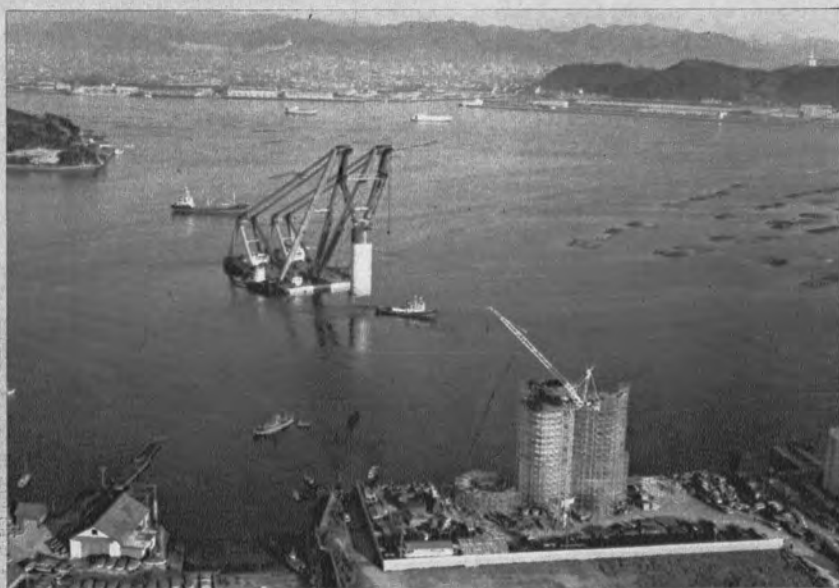
▲陸上でのケーソン製作ヤードの作業と 大形クレーン船によるケーソンの曳航 —広島呉道路1期・広島大橋下部工工事—
