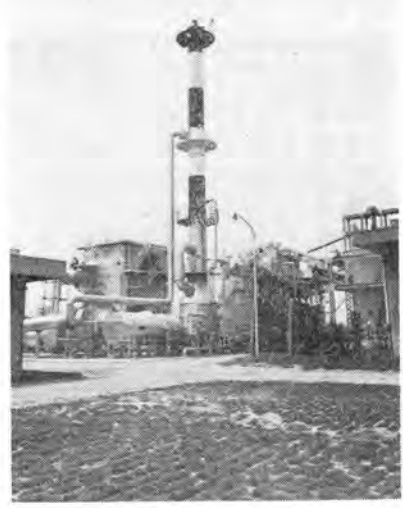
写真-9 汚泥焼却炉および排ガス処理施設（原田処理場）
