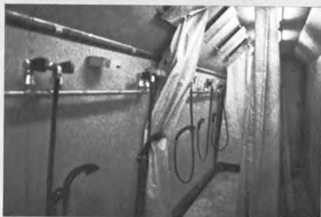
◀坑内用食堂・衛生車（北海道側先進導坑） 車内に食堂、シャワー室▼、乾燥室、調理室、水洗便所、クーラ設備、飲料水冷却設備などがある
