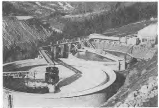
写真-1 草木ダム濁水処理設備
