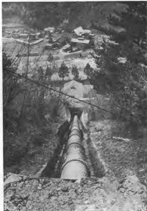
写真二 笛吹川第3発電所鉄管路
