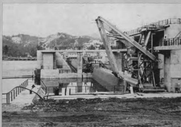
▲取水口油圧式自動除塵機
