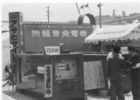
▲無騒音化の目立つ発電機
